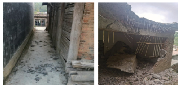
图3 建筑物震害情况照片
